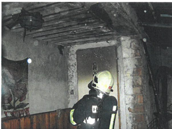
Požiar v priestore povaly spôsobený komínovým telesom
