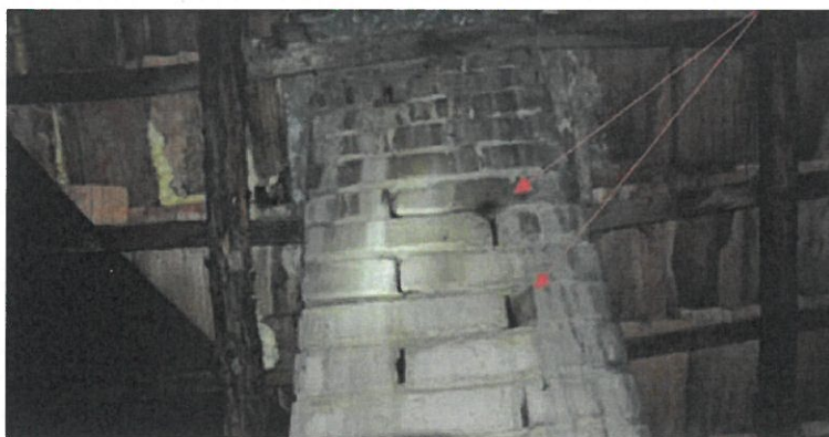
Nedostatočná vonkajšia úprava komína
